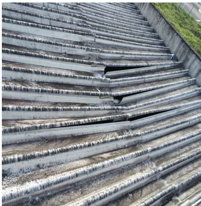
Telhado danificado permitindo infiltrações no forro de gesso
