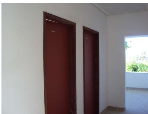
Figura 02 – Portas com fechadura Foto do fiscal – 2014
