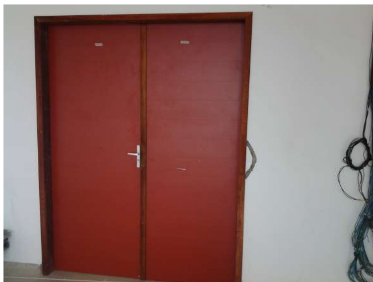
Figura 05 – Porta com fechadura e maçaneta em Abril de 2014 – Registro do fiscal.
