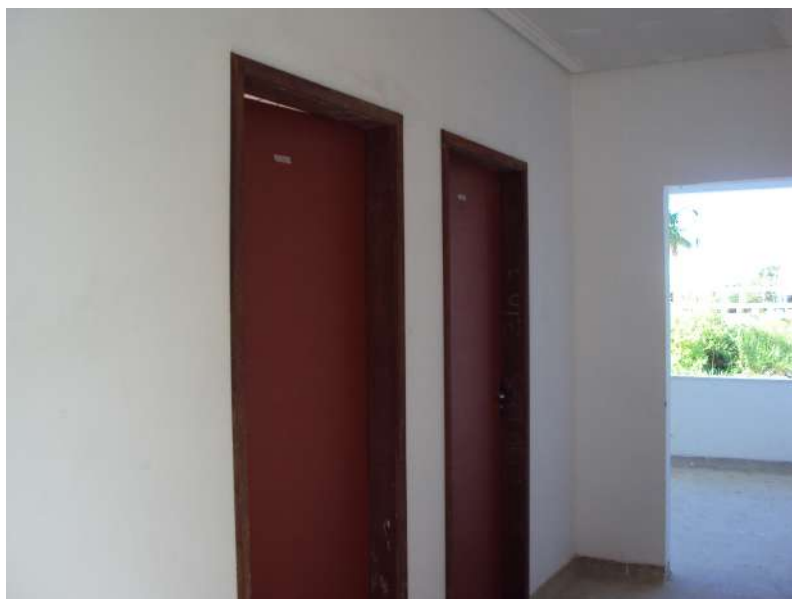
Figura 06 – Portas com fechaduras e maçanetas em Abril de 2014 – Registro do fiscal.
