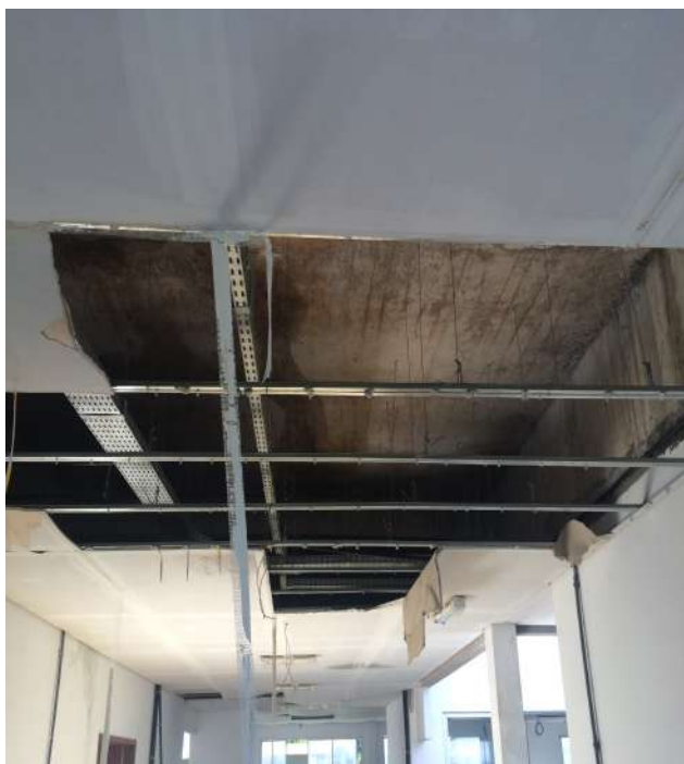
Parte do forro danificado por conta das infiltrações
