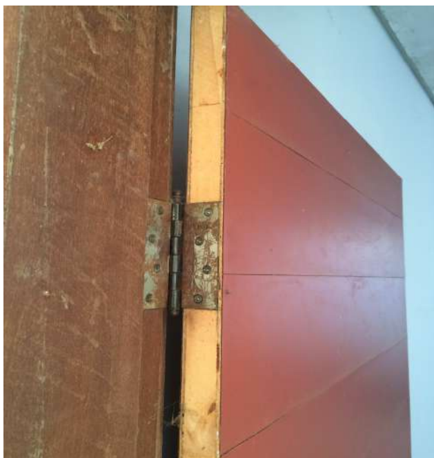
Dobradiça com especificações técnicas diferente do informado na planilha
