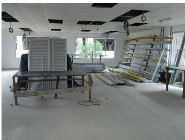
Figura 02 – Esquadrias de alumínio com venezianas Foto do fiscal – 2014
