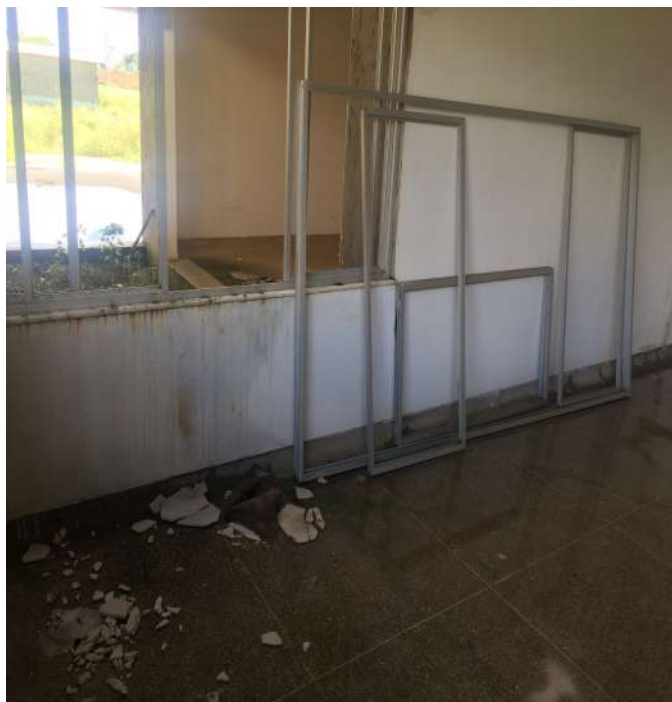
Esquadrias avariadas e dispostas inapropriadamente pelo piso
