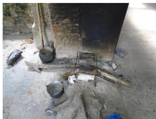
Figura 36: Piso de mármore axadrezado da capela do Engenho Vitória em estágio avançado de deterioração. Uso pelos pescadores.
