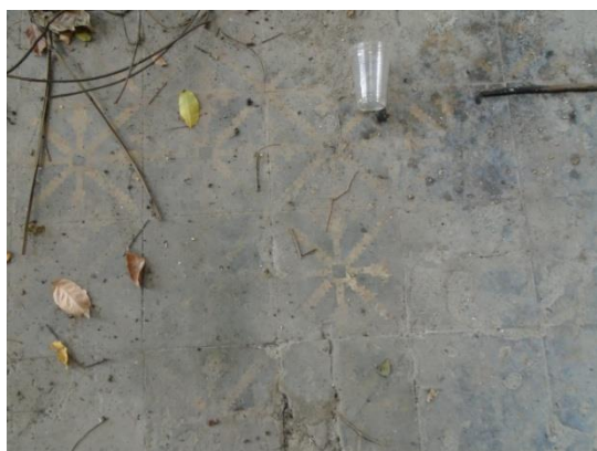
Figura 35: Piso de mármore axadrezado da capela do Engenho Vitória em estágio avançado de deterioração.
