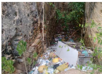
Figura 29: Chaminé da unidade fabril do Engenho Vitória em estágio de degradação.
