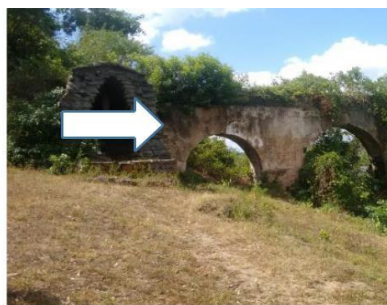
Figura 30: Ruína do aqueduto do Engenho Vitória.
