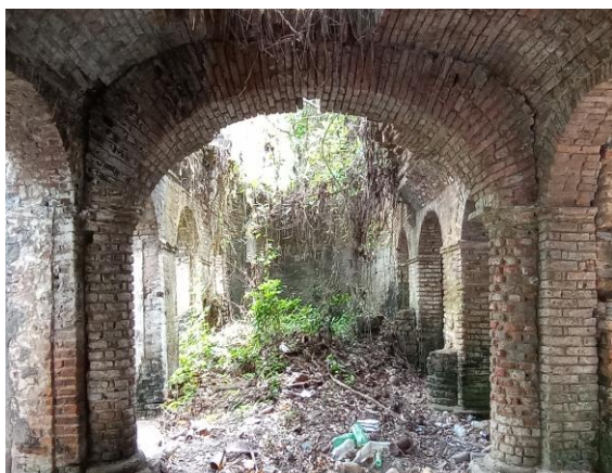
Figura32: Estrutura em deterioração da antiga capela do Engenho Vitória.
